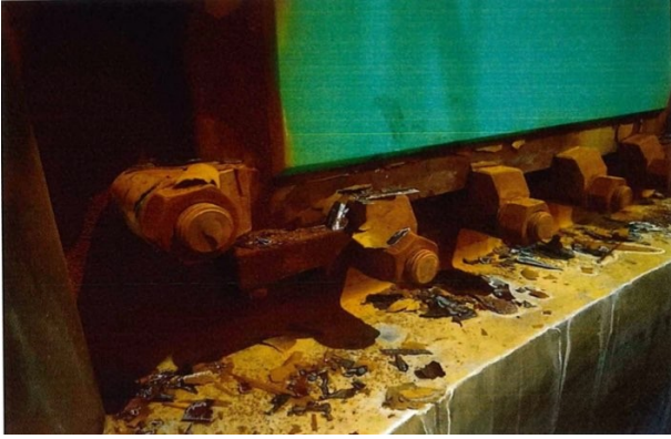
Ablagerungen auf dem Rahmen des Absperrschiebers
