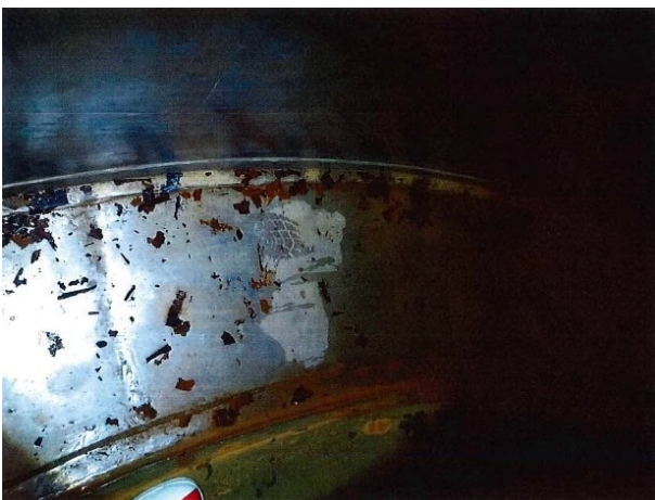
Ablagerungen auf der Hauptschweißnaht an dem Abtrennschieber
