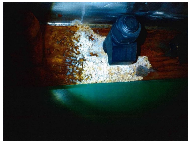
Auskristallisierte Borsäure ( H_3BO_3 ) auf dem Absperrschieberrahmen des Transportkanals
